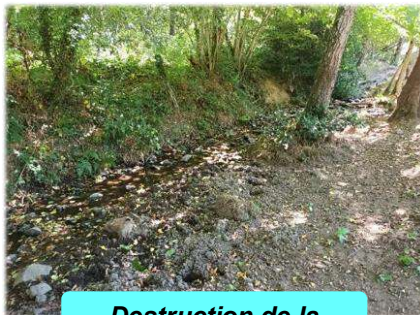
Destruction de la berge
